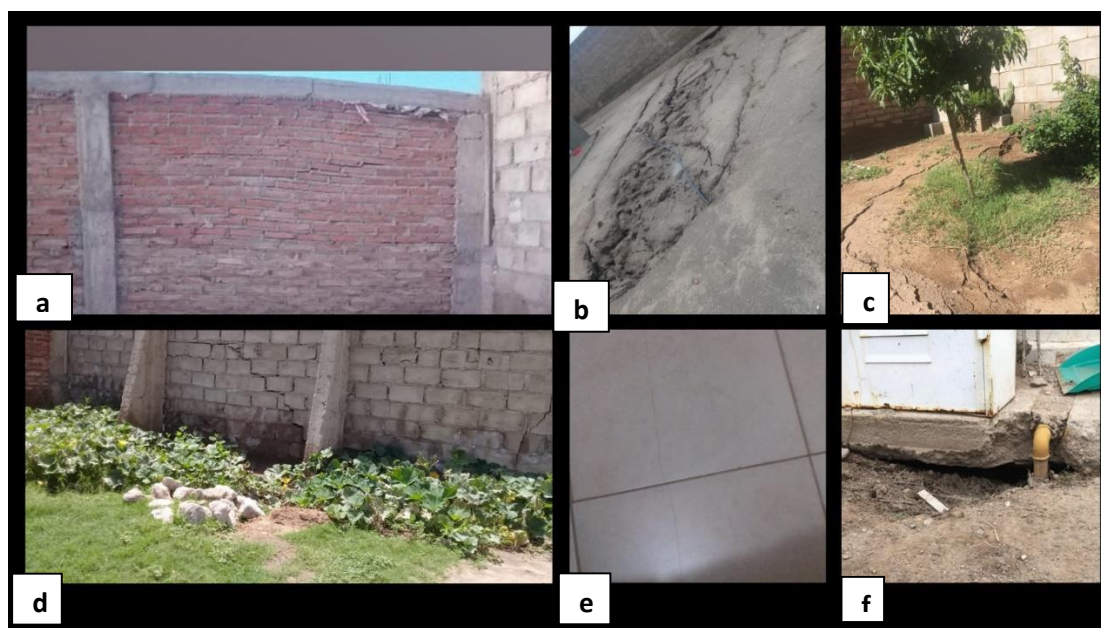
Fotografías 1: imágenes de algunas de las viviendas afectadas a) y d) vista de dos paredes medianeras, el aspecto de deformación producto del hundimiento b) y c) problemas de colapso de suelo e) vista de corrimiento del suelo en el interior de una vivienda con rotura de cerámicos f) Aspecto de colapso en el sector de frente
