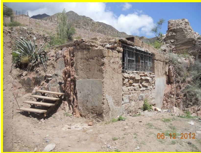
Figura 6. Fotografía del exterior del recinto donde fue instalado el sistema de EA, Cacheuta, prov. Mendoza.
