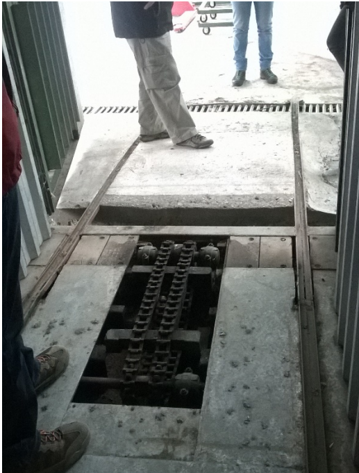
Fig. 1: Sistema mecánico de movimiento de carros al interior del túnel. Fuente: INTA de Rama Caída, Mendoza.
